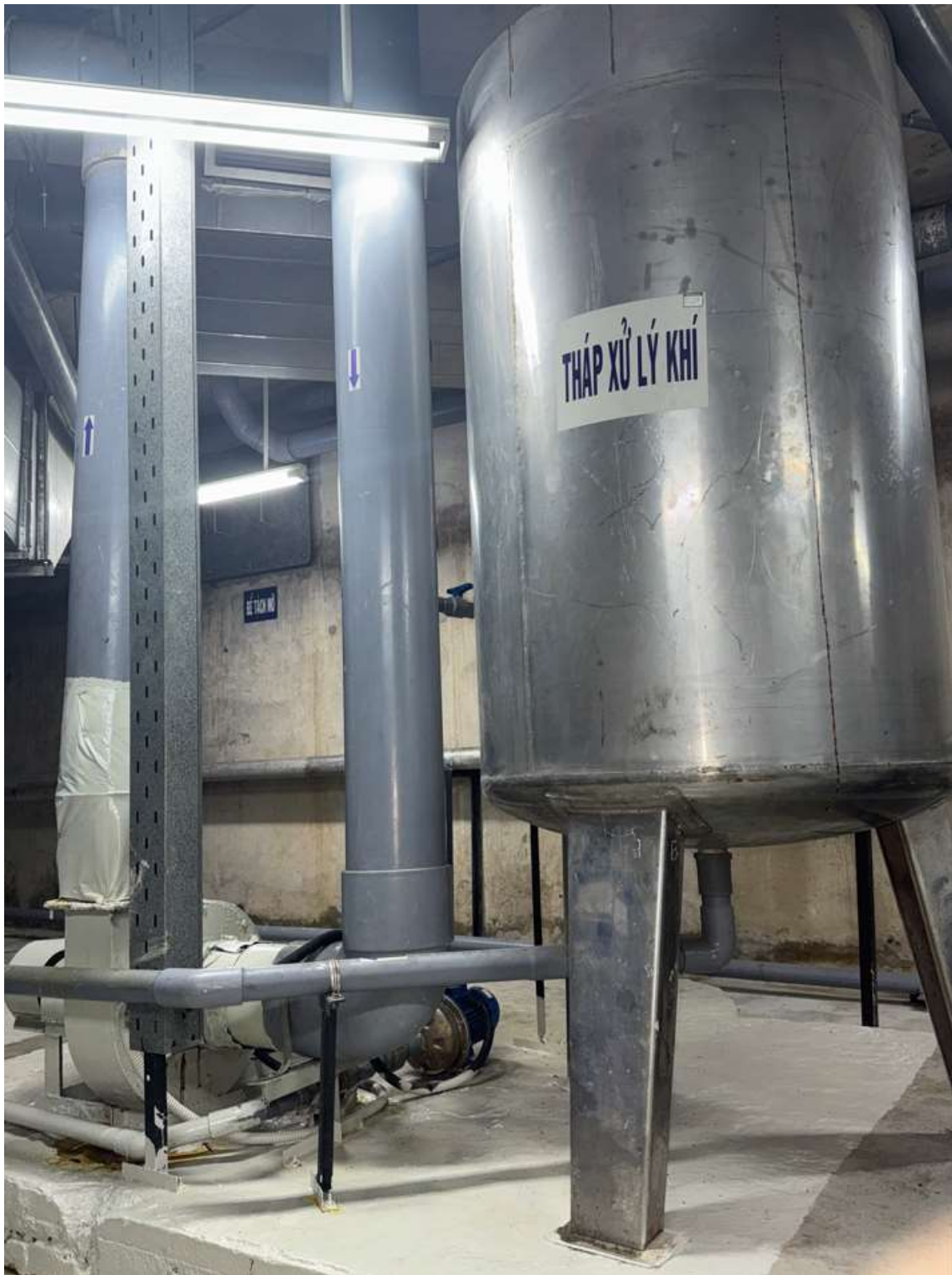
Tháp xử lý mùi
