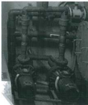
Hệ thống máy bơm
