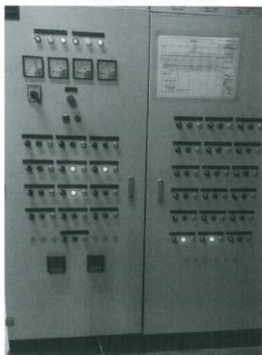
Tủ điều khiển
