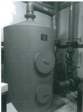
Tháp xử lý mùi
